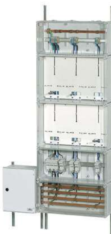
Para 5 contadores monofásicos e trifásicos e corte de 250A. Exemplo de montagem.
