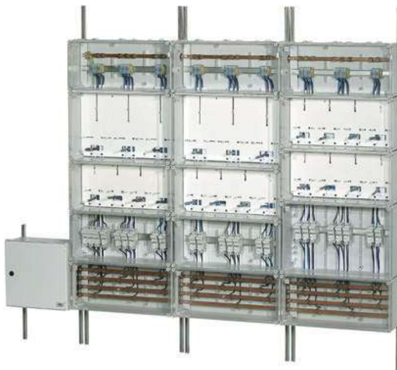
Para 16 contadores monofásicos e trifásicos e corte de 400A. Exemplo de montagem.
