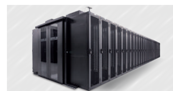
Corredor de contenção térmica Data Center
